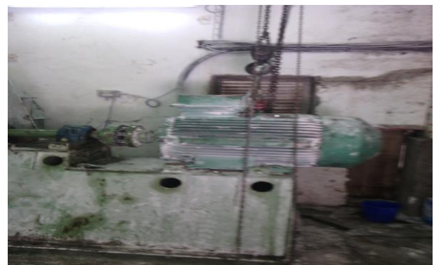
Photo 1-1 FAN AXIAL BURNER
